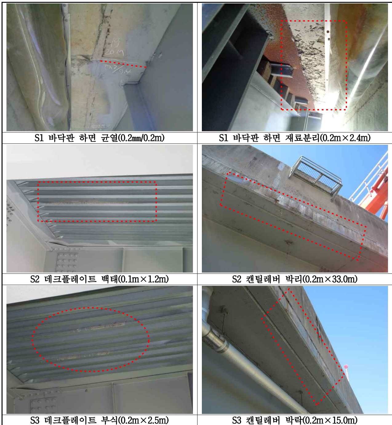
【사진 3.28】 바닥판 손상현황
