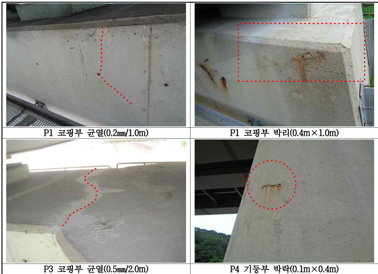
【사진 3.36】교각 손상현황
