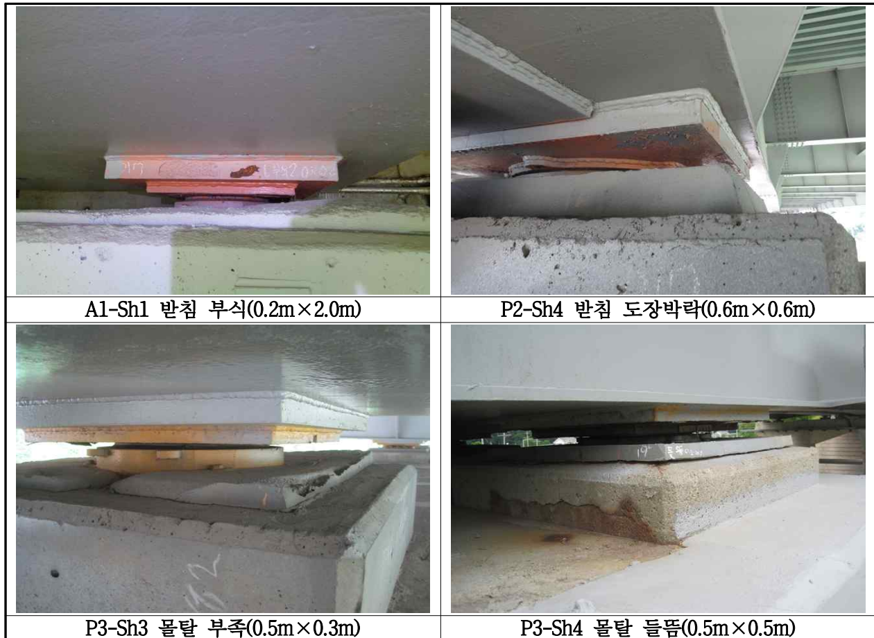
【사진 3.38】 교량받침 손상현황
