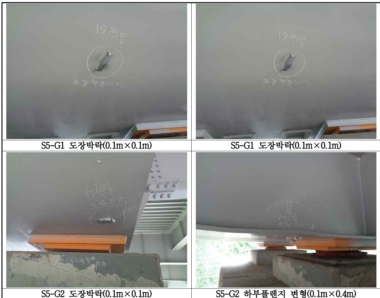
【사진 3.30】 거더 외부 손상현황
