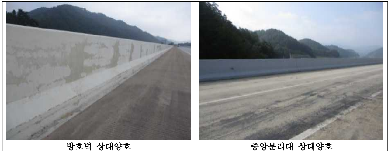
【사진 3.24】 방호벽 및 중앙분리대 손상현황
