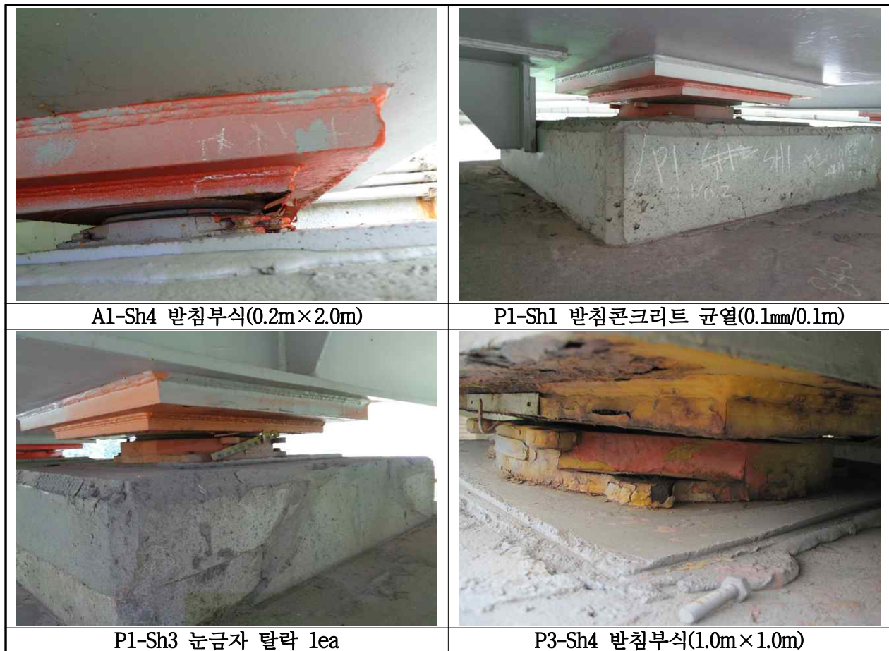
【사진 3.13】 교량받침 손상현황
