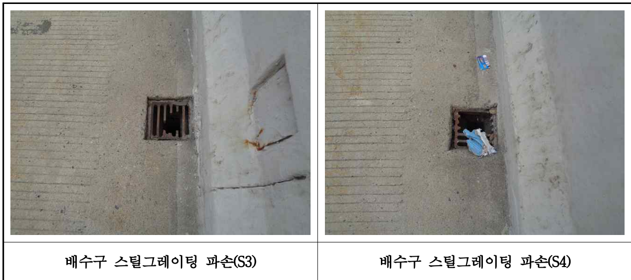
【사진 3.22】 배수시설 손상현황
