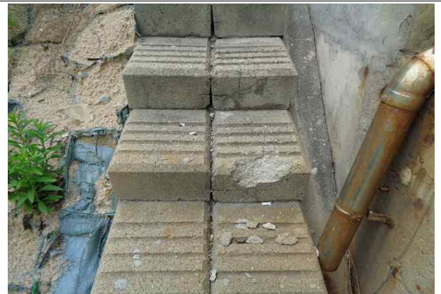
A1 점검계단 파손(0.2m×0.4m)
