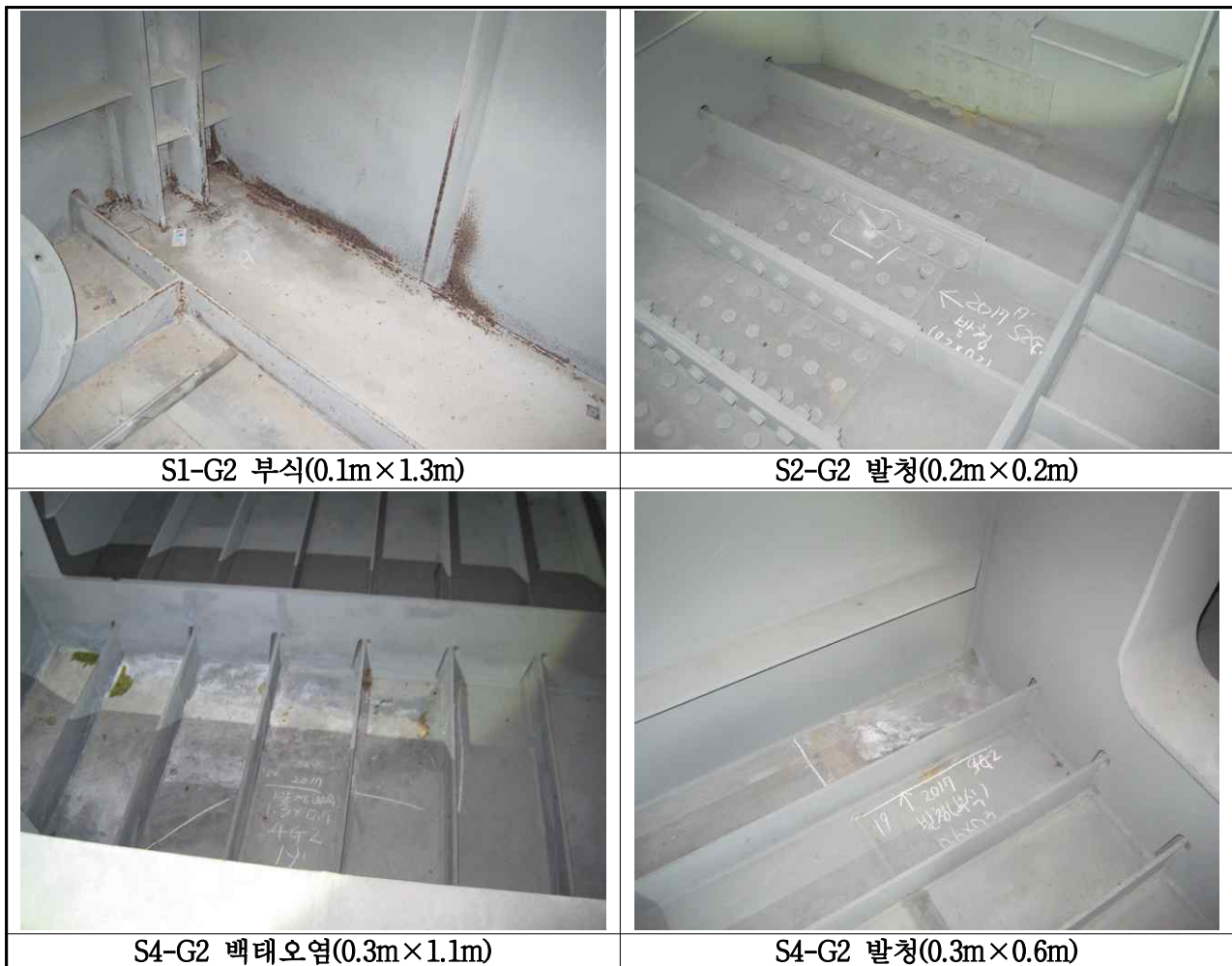
【사진 3.31】 거더 내부 손상현황
