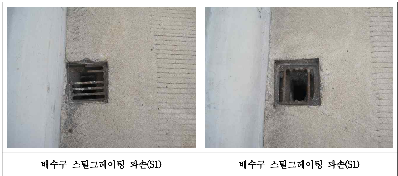
【사진 3.47】 배수시설 손상현황
