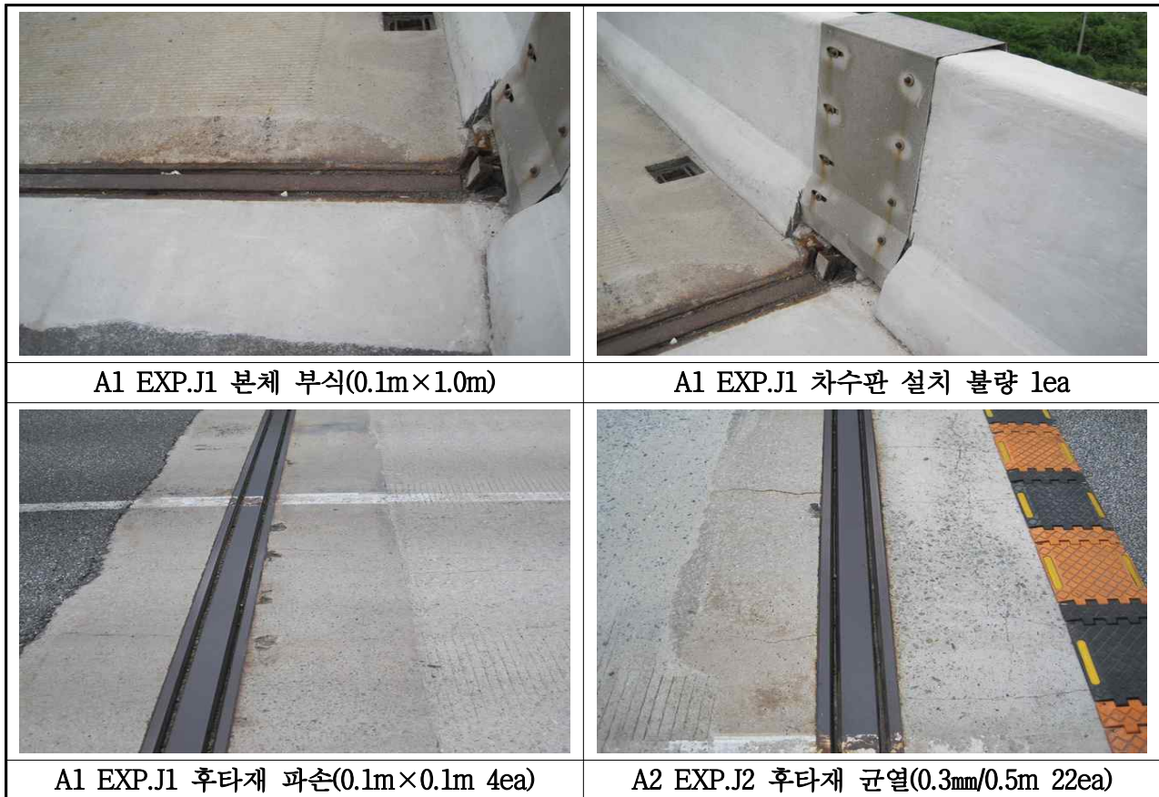
【사진 3.42】 신축이음장치 손상현황
