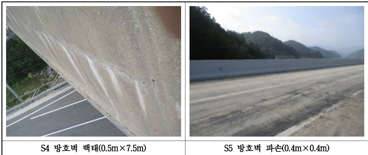
【사진 3.49】 방호벽 및 중앙분리대 손상현황
